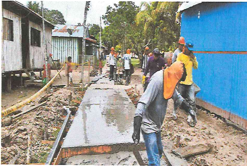
FOTO N° 15: SE OBSERVA VACEO DE MORTERO DE VEREDA EN LA COMUNIDAD DE ANCASH.
