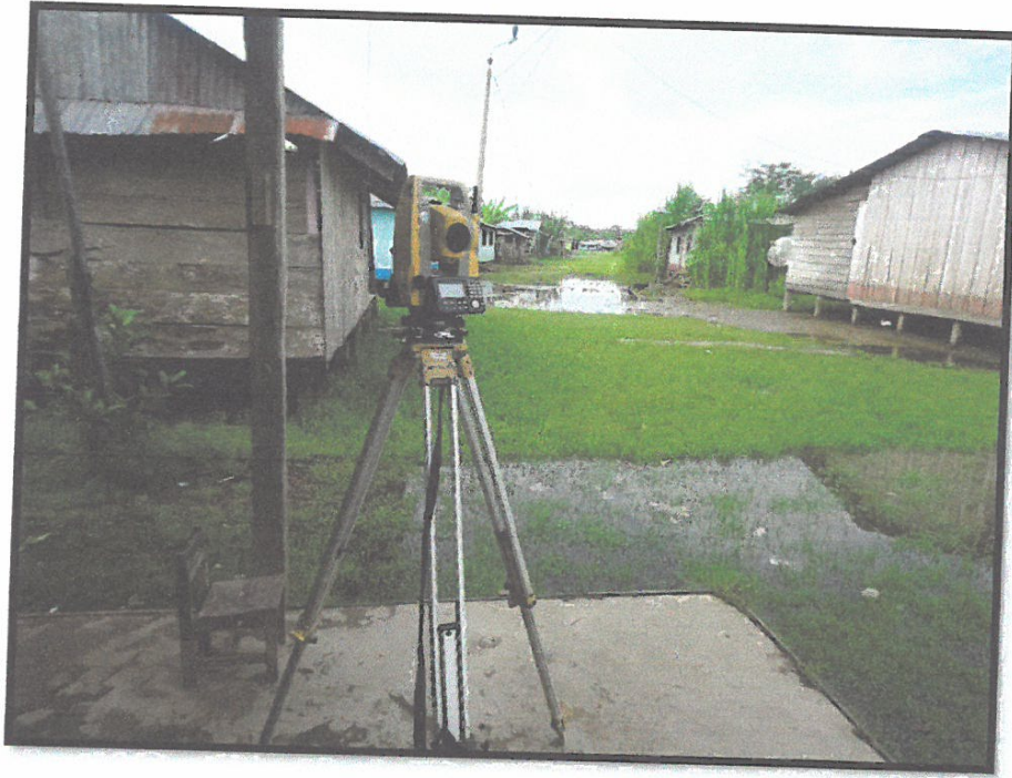
FOTO N° 07: Se puede observar los trabajos de Replanteo de la Obra en Bellavista
