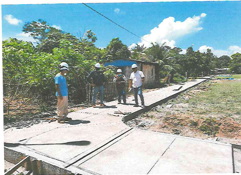
FOTO N° 13: SE OBSERVA TRABAJOS DE VACEO DE MORTERO F'c= 210 KG/CM2 EN VEREDAS EN LA COMUNIDAD DE ANCASH.
