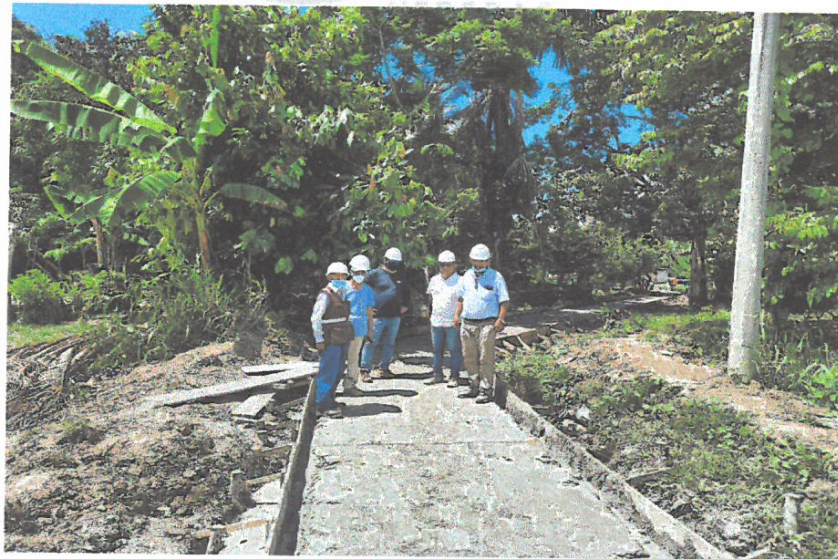
FOTO N° 10: SE OBSERVA TRABAJOS DE ENCOFRADO, EXCAVACIÓN MANUAL, COLOCACIÓN DE CAMA DE ARENA Y VACEO DE SOLADO EN VEREDAS EN LA COMUNIDAD DE ANCASH.
