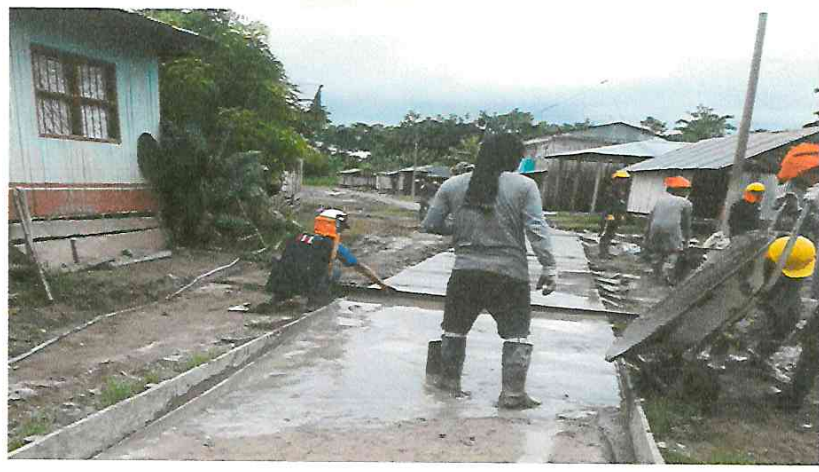
FOTO N° 12: SE OBSERVA VACEO DE MORTERO DE VEREDA EN LA COMUNIDAD DE SAN CARLOS.
