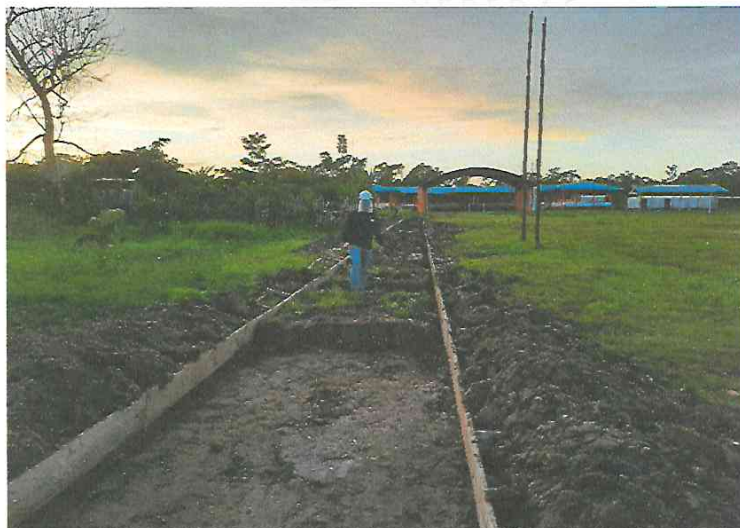
FOTO N° 02: SE OBSERVA ENCOFRADO EN VEREDAS, Y EXCAVACIÓN MANUAL EN LA COMUNIDAD DE HUACRACHIRO.
