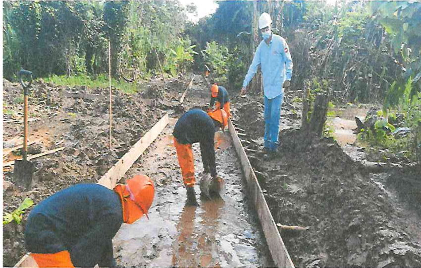
FOTO N° 05: SE OBSERVA ENCOFRADO EN VEREDAS, Y EXCAVACIÓN MANUAL EN LA COMUNIDAD DE SAN CARLOS.
