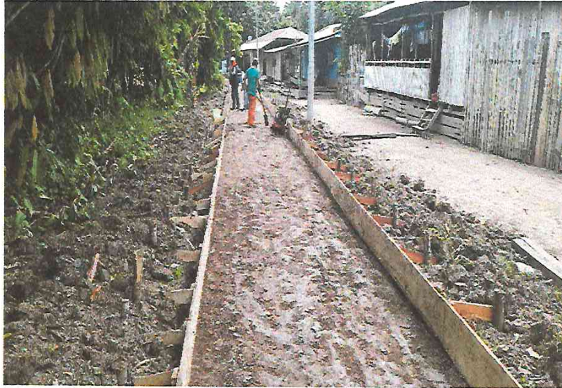
FOTO N° 11: SE OBSERVA COLOCACION DE CAMA DE ARENA, ENCOFRADO EN VEREDAS Y COMPACTACIÓN DE TERRENO EN LA COMUNIDAD DE BELLAVISTA.
