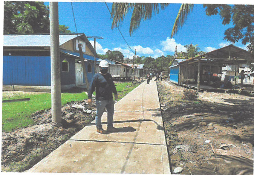
FOTO N° 12: SE OBSERVA TRABAJOS DE VACEO DE MORTERO F'C= 210 KG/CM2 EN VEREDAS EN LA COMUNIDAD DE ANCASH.
