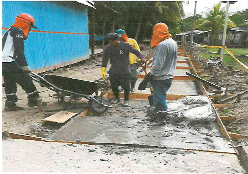
FOTO N° 11: SE OBSERVA VACEO DE MORTERO DE VEREDA EN LA COMUNIDAD DE SAN CARLOS.
