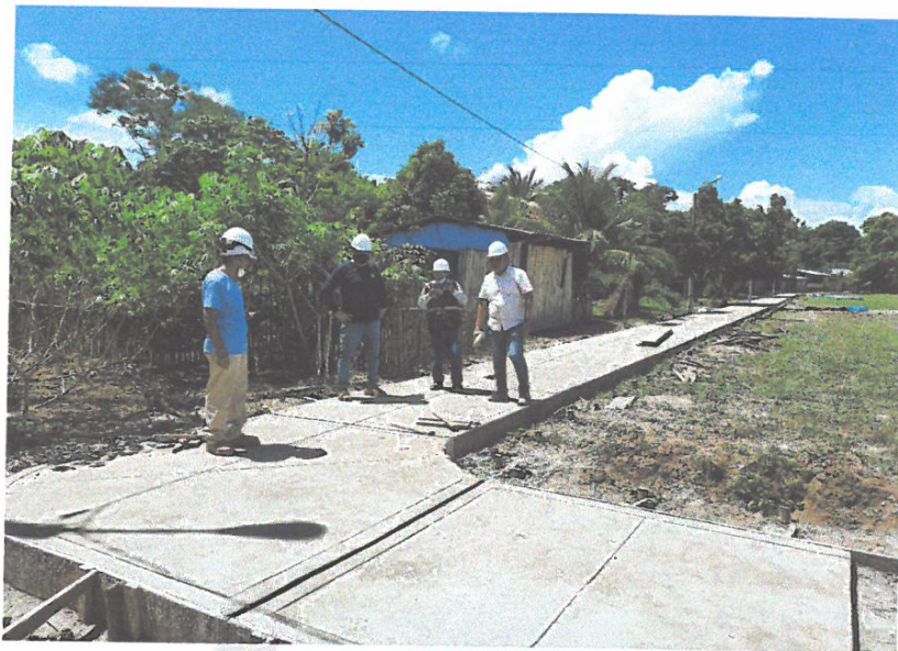
FOTO N° 13: SE OBSERVA TRABAJOS DE VACEO DE MORTERO F' C= 210 KG/CM2 EN VEREDAS EN LA COMUNIDAD DE ANCASH.
